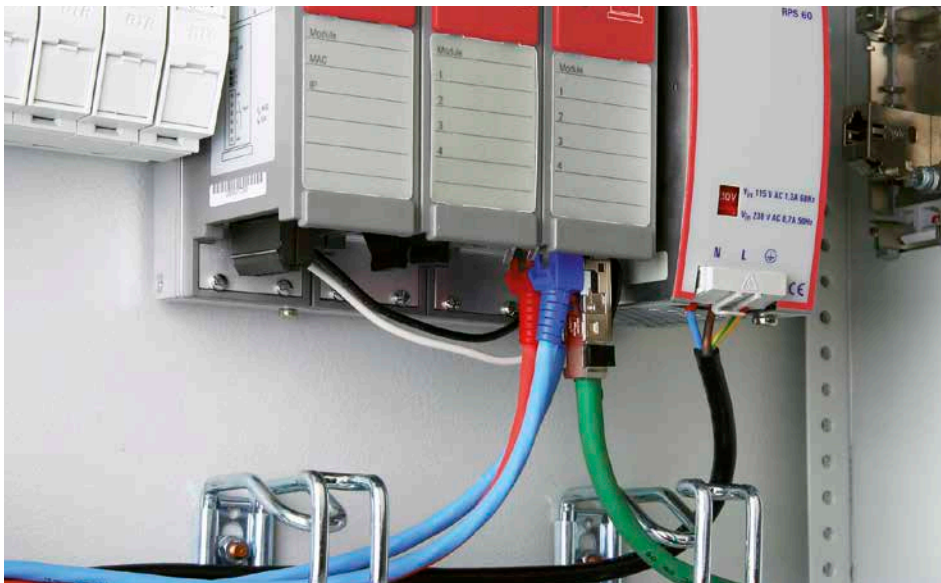
Illustr. 5 : Branchement direct dans le distributeur industriel
